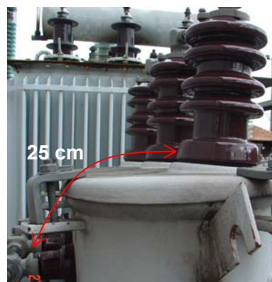
Figura 01: A distância entre as buchas de AT e BT é inferior à distância mínima de segurança impedindo o trabalho do eletricista de BT sem a colocação de barreiras isolantes na AT.
