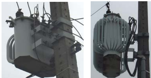
Figura 02: Transformadores com as buchas de BT instaladas na parte superior do tanque: dificuldade para o acesso do eletricitista.
