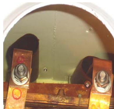
Figura 04: Detalhe interno das conexões entre os terminais do enrolamento de baixa tensão e suas buchas.
