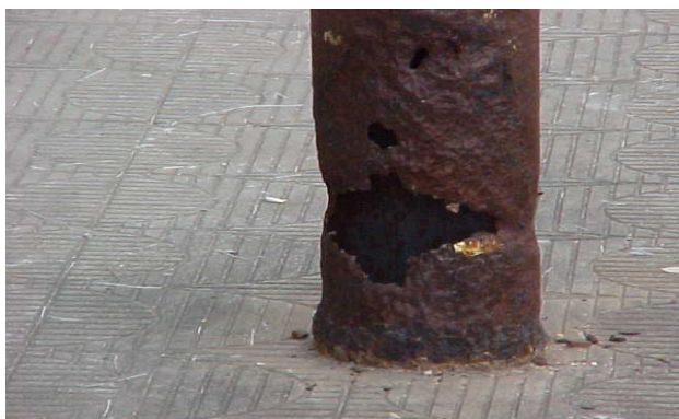
Fig. 8 – Poste tubular de aço com corrosão em sua base
