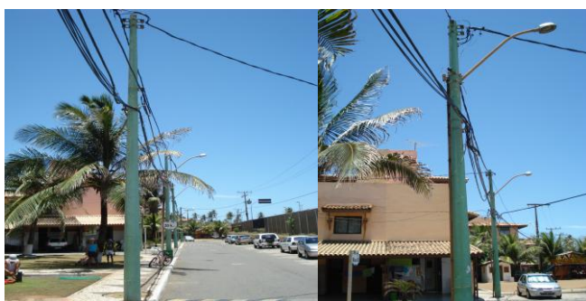
Fig. 7 – Poste de concreto com pintura epóxi
