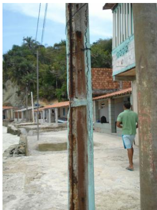
Fig. 6 – Poste de concreto, efeito ação salitrosa.
