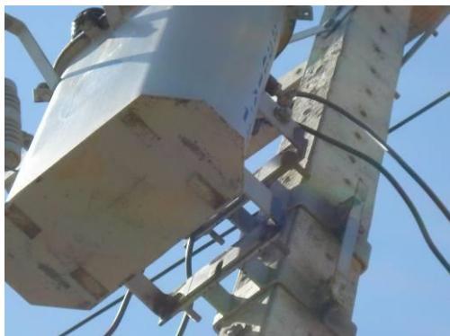
Fig. 11 – Transformador soldado na tampa e cintas soldado
