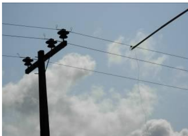
FIGURA 7 – DETALHE DE CURTO-CIRCUITO FASE-TERRA PROVOCADO NA REDE DE 34,5 kV
