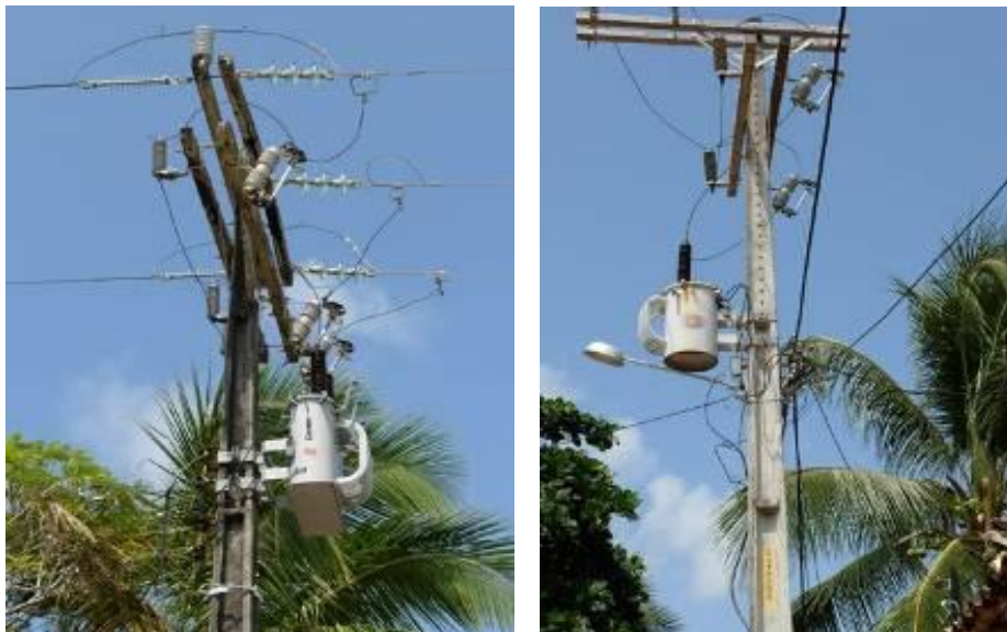
FIGURA 6 – DETALHE DOS TRANSFORMADORES DE DISTRIBUIÇÃO DOS POSTOS 1 E 2
