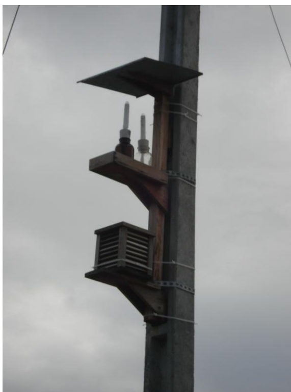
Figura 1. Coletor de cloretos, via método da vela úmida, ABNT NBR 6211 [7], instalado no Complexo Sauípe.
