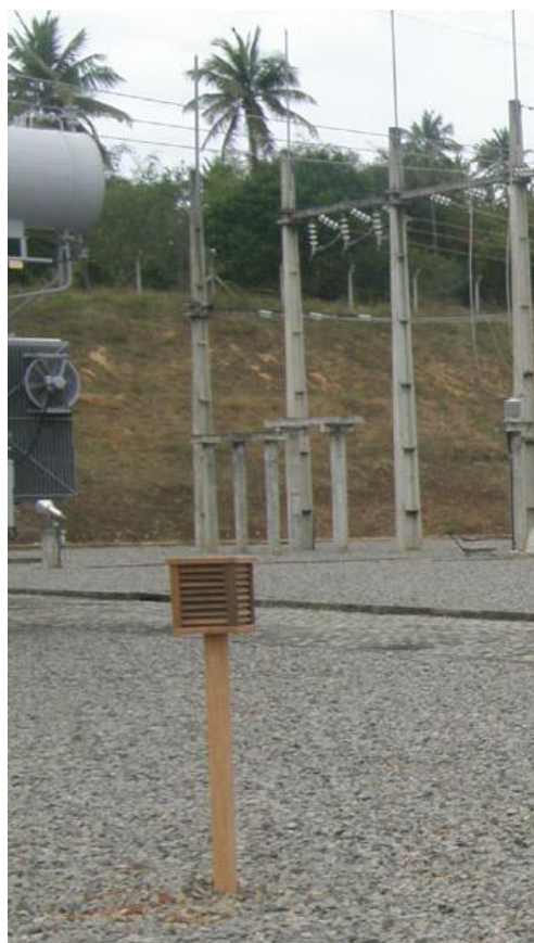
Figura 2. Coletor de sulfatos, via método da vela de dióxido de enxofre, instalado na SE Sauípe.
