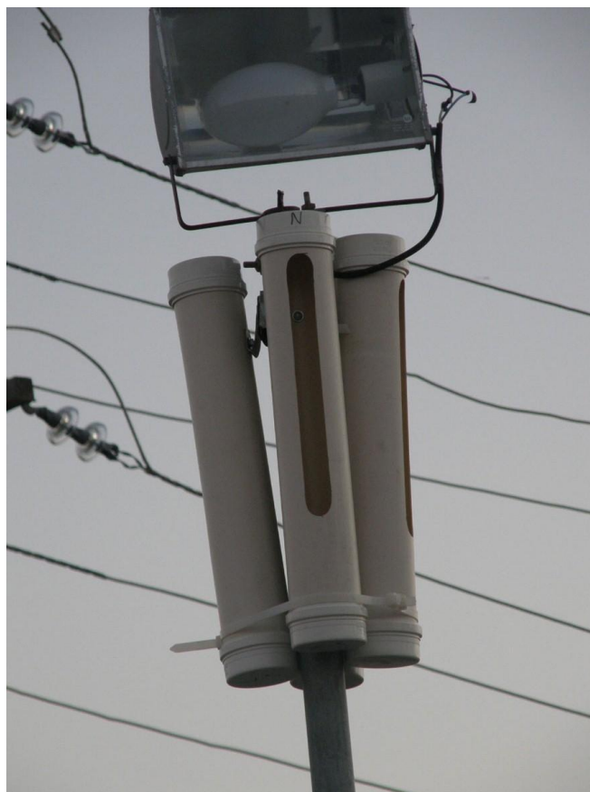
Figura 3. Coletor de DDDG instalado na SE Porto Seguro, BA.
