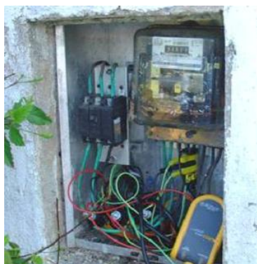
Figura 4 – Registrador de Eventos em Caixa de Entrada de Consumidor (Posto 2)
