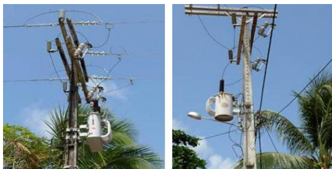
Figura 6 – Detalhe dos Transformadores de Distribuição dos Postos 1 e 2
