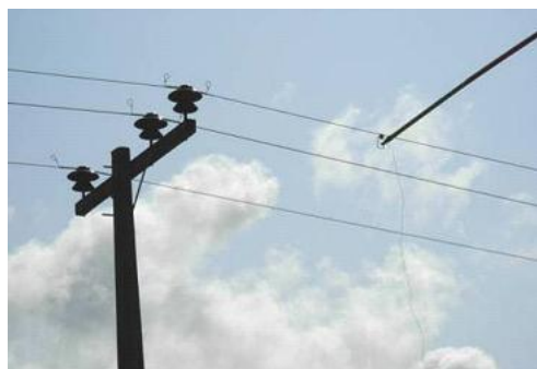
Figura 7 – Detalhe de Curto-Circuito Fase-Terra Provocado na Rede de 34,5 kV
